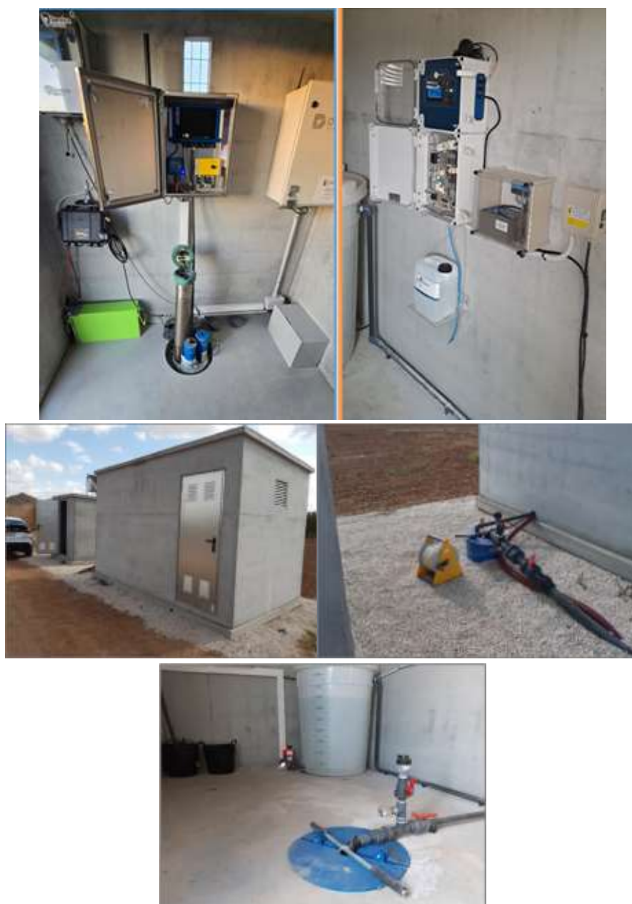
Figura 53. Sondeos y equipos de medida. Arriba izqda.: sondeo con sondas de medida de nitratos en continuo instalada; arriba dcha.: mini laboratorios portátiles; centro izqdo.: vista exterior de las casetas en cuyo interior se ubican los sondeos y equipos de medida; centro dcho.: pozo de bombeo para movilizar las aguas del acuífero de manera previa a las mediciones; abajo: sondeo de extracción y depósito de recogida del agua de los minilaboratorios.
