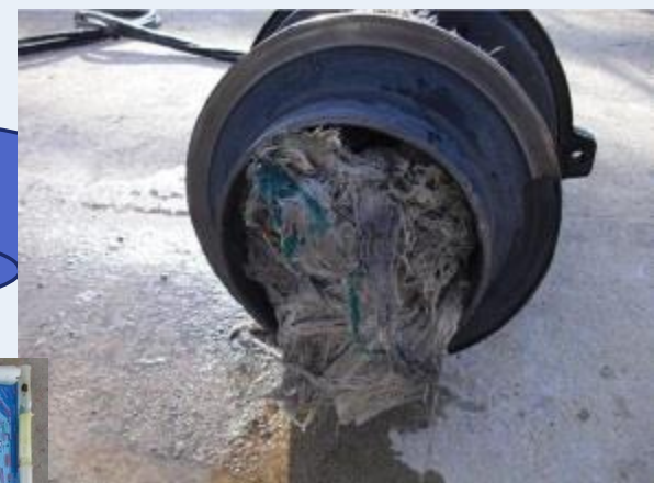
Fuente: Consorcio de Aguas Bilbao Bizkaia
