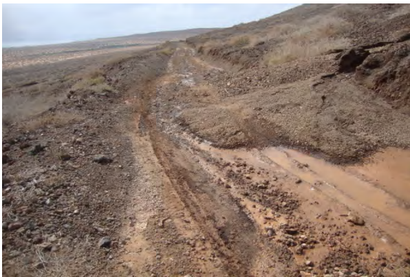
Ilustración 22.- Arrastre de sólidos sobre la capa de rodadura
