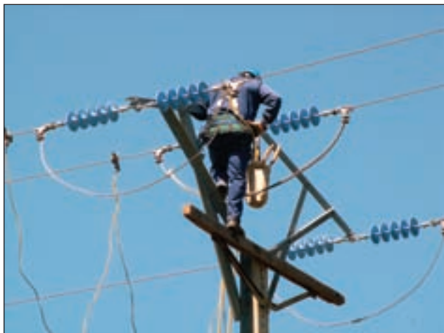
Figura 4-78. Las modificaciones de los apoyos de tendidos eléctricos peligrosos para las aves tienen como objetivo convertirlos en inocuos para la electrocución. Es preferible realizar cambios estructurales eficaces y permanentes.
