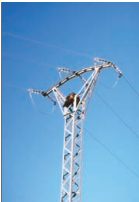
Figura 4-76. Apoyo en tipo amarre de un tendido eléctrico con un águila real electrocutada en la base de la bóveda.
