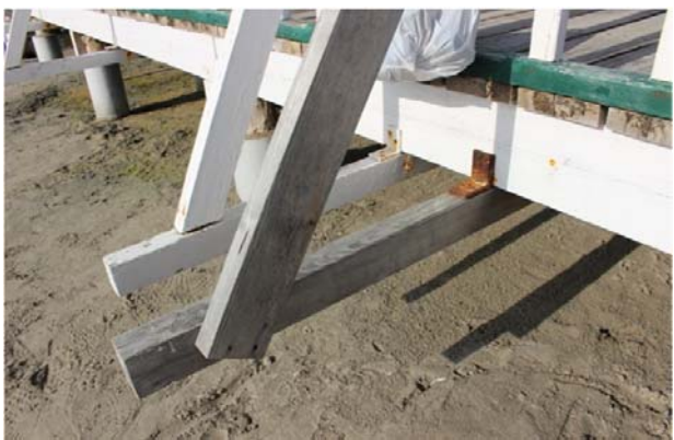
Duplicación de tornapuntas y oxidación de piezas metálicas.
