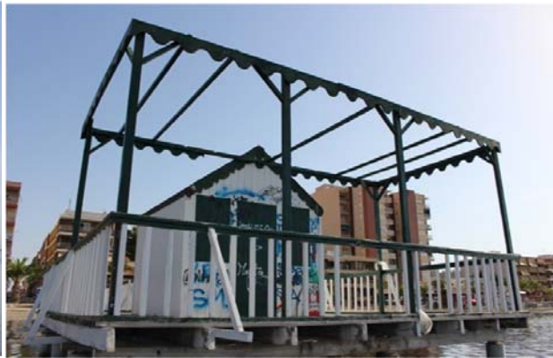
Parte posterior de caseta y pérgola. Ausencia de correas de pérgola, montantes de barandilla
