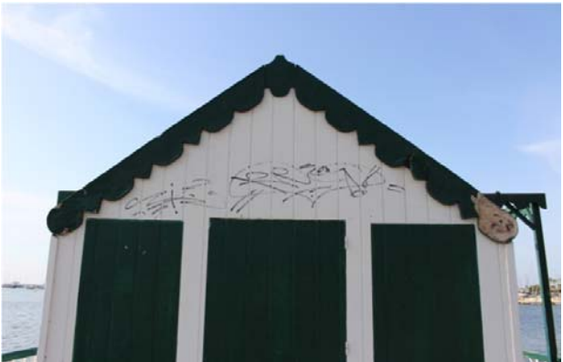
Deterioros de las piezas de alero y rotura del tímpano Ventanas simuladas en la fachada mediante la pintura
