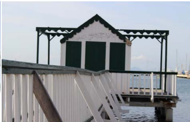
Ligero asentamiento en uno de los pilotes de la pasarela
