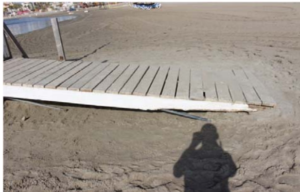
Deterioro de la correa de la rampa en el arranque. Montante inadecuado y restos de antiguos conductos
