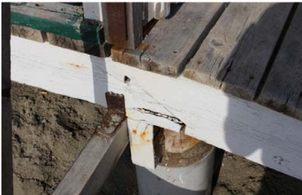
Oxidación de angulos de refuerzo. Grietas en correa
