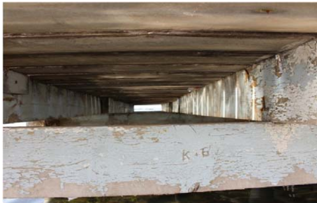
Buen estado general de correas y tablazón. Pintura inadecuada
