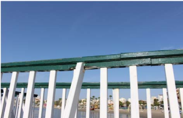
Pérdica de sección y discontinuidades en pasamanos
