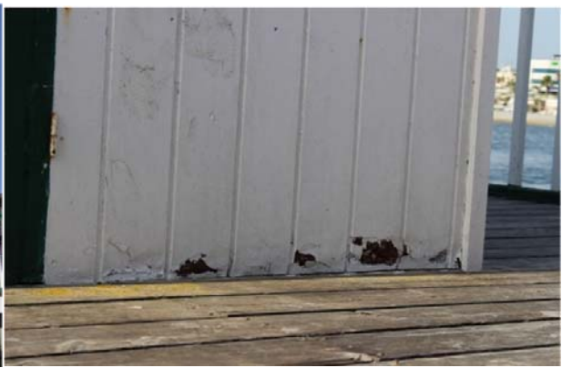
Putrefacción de las tablas de la caseta en zona inferior
