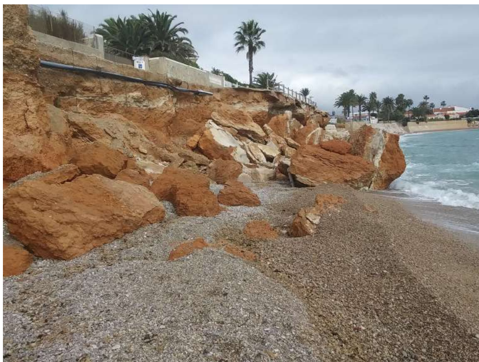
Figura 4: Zona de actuación. Vista derrumbe talud. Elaboración propia. [Oct-2022]
