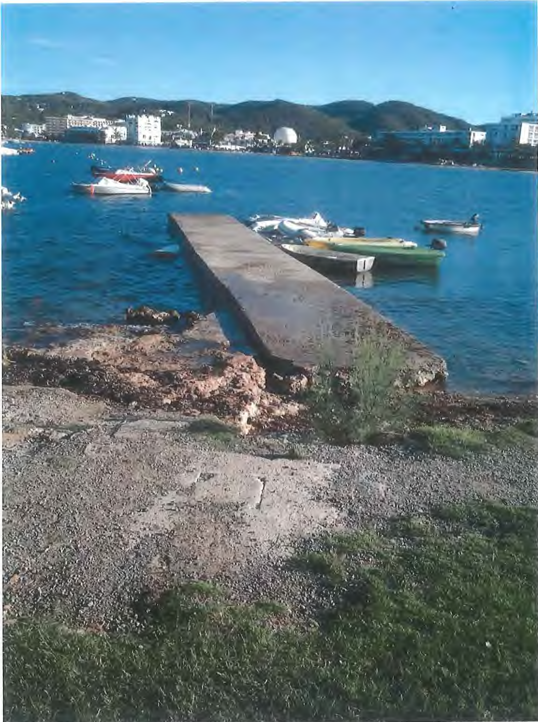
Fotografía 7.- Detalle de arranque del embarcadero, puede observarse la superficie del hormigón en un estado de conservación aceptable. Se produce de forma reiterada, el amarre de embarcaciones en el costado derecho de dicho embarcadero, a pesar de estar balizado como zona de baño, así como la inexistencia de elementos de amarre competentes.
