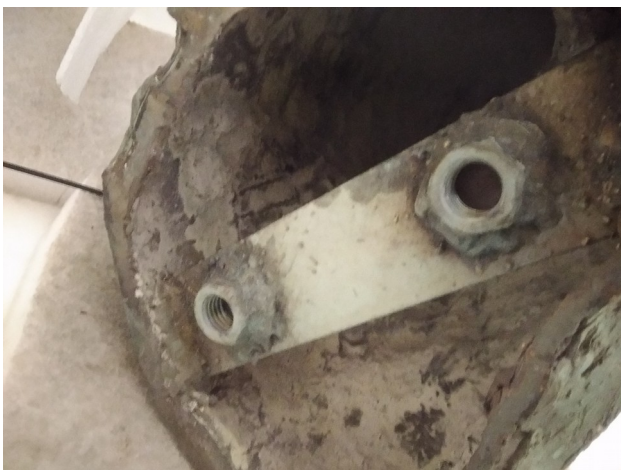
Tuercas donde roscarán las varillas que se colocarán en los taladros realizados a la piedra
