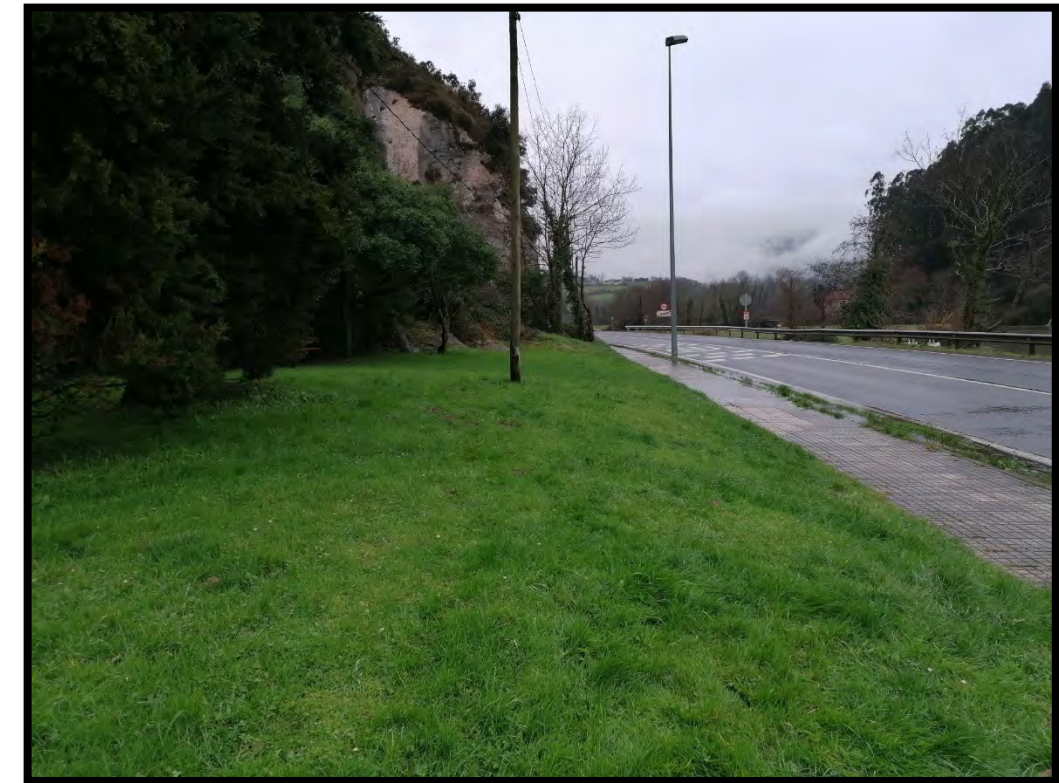
Fotografía nº6.- Zona de ejecución de pozo de ataque de la hinca bajo la N-621
