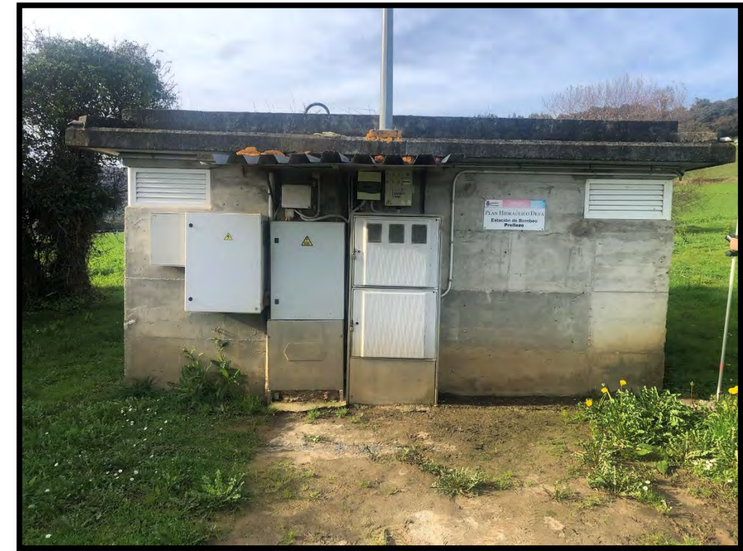
Fotografía nº12.- Vista de los cuadros eléctricos del bombeo de Prellezo
