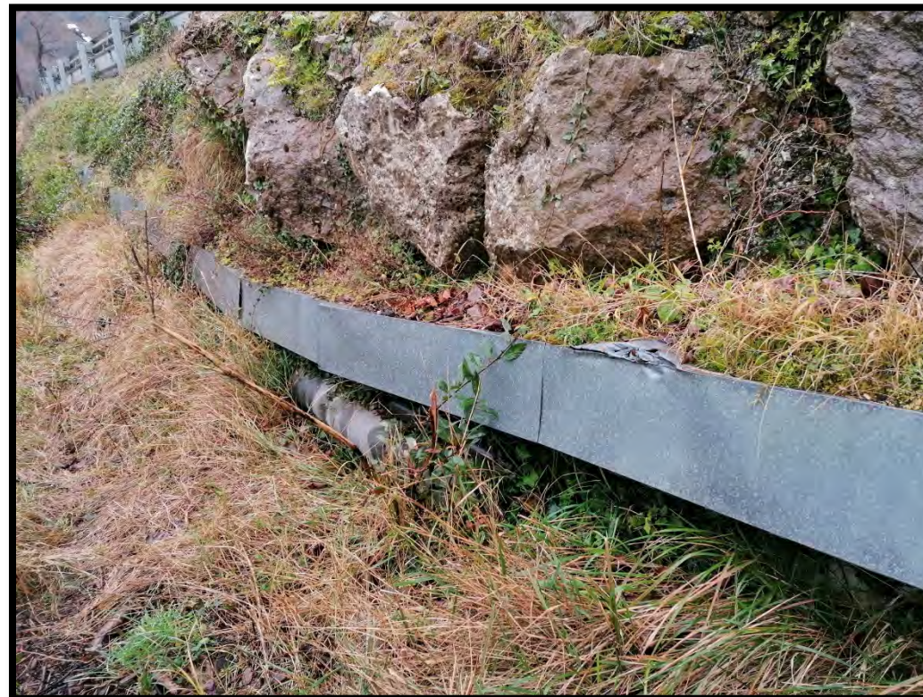
Fotografía nº5.- Tubería actual grapada a muro de mampostería
