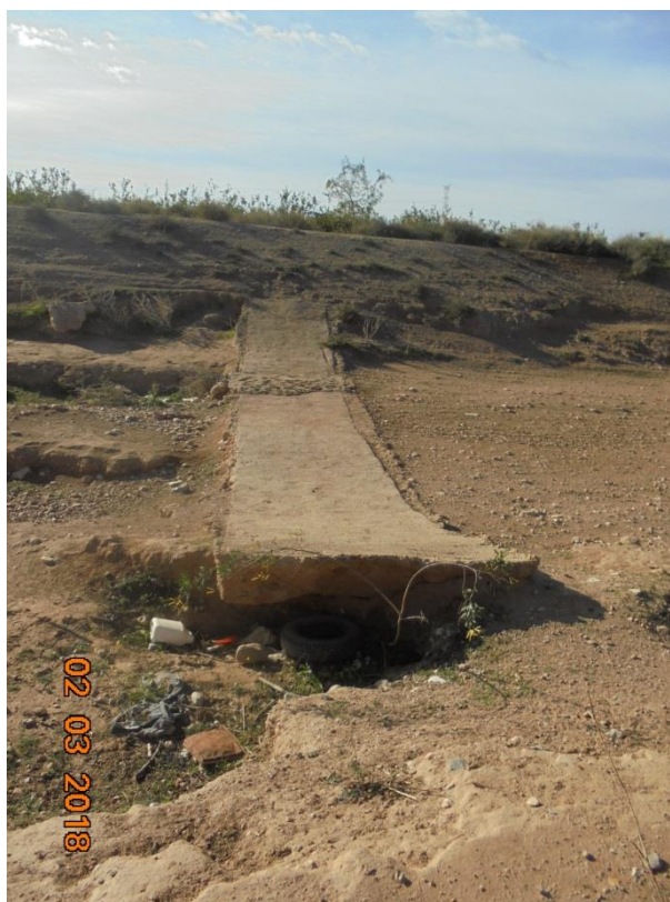
Figura 13: Umbral de fondo en mal estado en la Rambla del Albuñón, en el tramo entre Los Conesas y Albuñón. Se puede apreciar la erosión en márgenes y lecho del cauce
