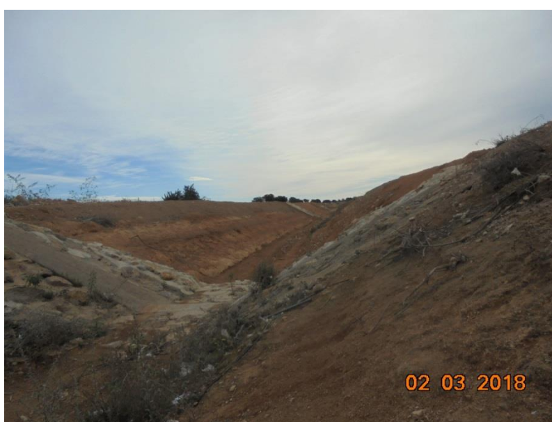
Figura 14: Ejemplo de tramo con encauzamiento y rastrillos en la Rambla del Albuji3n (entre el Canal del Campo y Pozo Estrecho).
