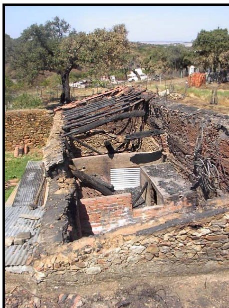
Imagen 20 – Tejado de madera no evaluado (30 pts) – No asegura ningún tipo de protección.
