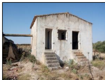
Bombeo de agua bruta
