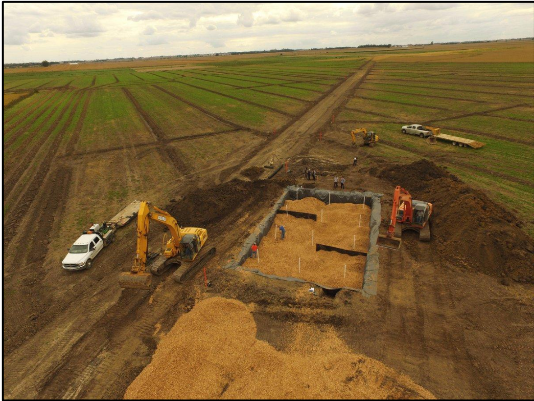
Figura 2. Construcción de un Biorreactor de astillas de madera en un campo de Iowa (EEUU). Foto: N.D. Bowman
