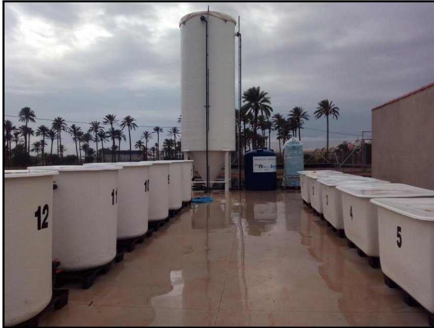
Figura 7. Imagen de los doce biorreactores ya instalados para la desnitrificación de las salmueras
