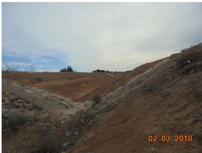
Figura 14: Ejemplo de tramo con encauzamiento y rastrillos en la Rambla del Alujón (entre el Canal del Campo y Pozo Estrecho).
