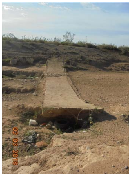
Figura 13: Umbral de fondo en mal estado en la Rambla del Albuñón, en el tramo entre Los Conesas y Albuñón Se puede apreciar la erosión en márgenes y lecho del cauce
