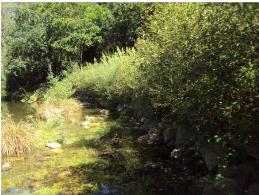
Foto 6. Muro Krainer después de dieciocho meses en actuación de río Tamuxe (Oia, Pontevedra).
