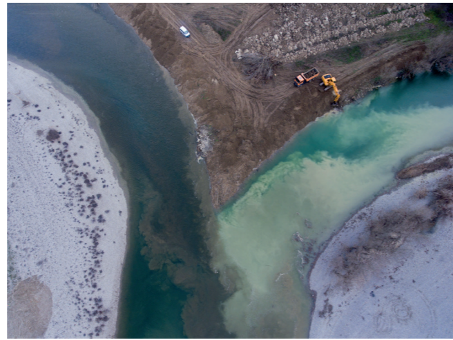
Eliminación de escollera en la confluencia de los ríos Arga y Aragón.
