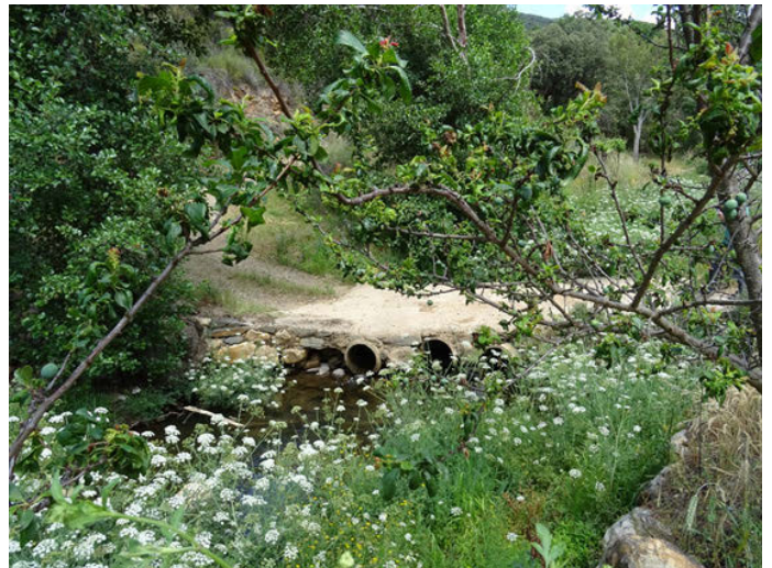
Foto 10: Paso entubado en la zona 1
