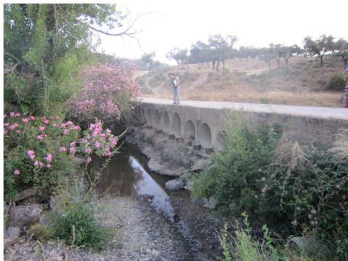
Foto 22: El vado de la foto anterior, mostrando descalzamiento (junio 2017)
