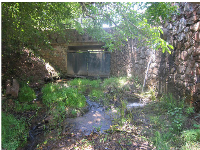
Foto 26: Puente en cabecera del arroyo de la Fuente del Casta帽o (a unos 100 m del vado de la foto anterior) presenta un cerramiento metรกlico y salida de agua de acequia por tubo en muro.
