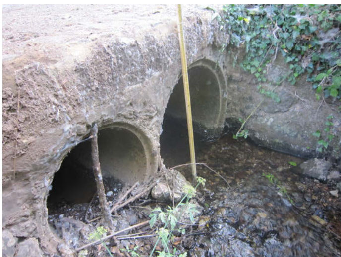
Foto 2: El mismo paso entubado de la foto anterior, mostrando acumulación de materiales.
