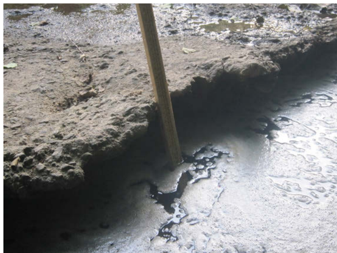
Foto 16: Detalle del vado anterior; mostrando el descalce de la capa de hormigón
