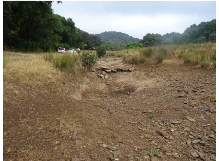
Foto 14: Vado erosionado en el Aº del Tinte.
