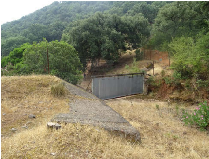
Foto 15: Vallado cinegético infranqueable del Aº del Tinte. Con muro de piedra lateral.
