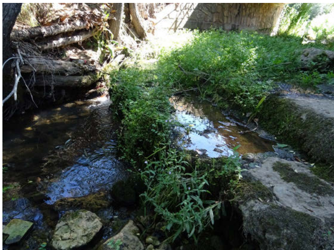
Foto 13. Obstáculo transversal ocasionado por el puente de la carretera TE-02
