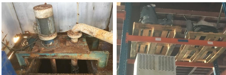
Fig. 44: Medidas de autoprotección en Teknia: bombas de achique.
