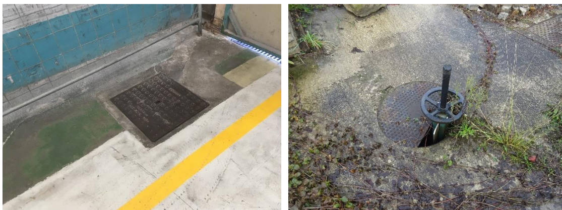
Fig. 43: Medidas de autoprotección en Teknia: válvulas antirretorno en la red de saneamiento y drenaje, y válvula de guillotina en la arqueta principal.
