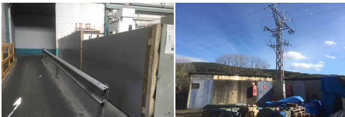
Fig. 52: Equipamientos protegidos: maquinaria y centros de transformación.
