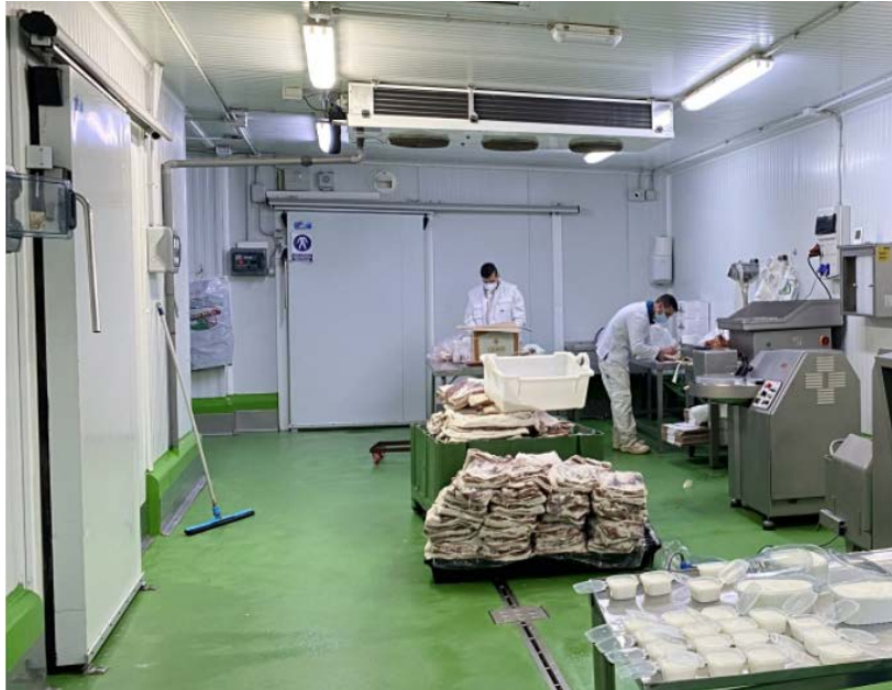
Ilustración 29. Sala con refrigeración para conservación de carnes (fuente: https://pipuntealto.com/ )
