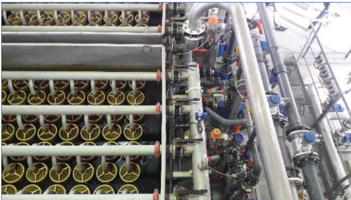
Figura 14. Sistemas de ultrafiltración en la EDAR de Boadilla del Monte (Madrid).
