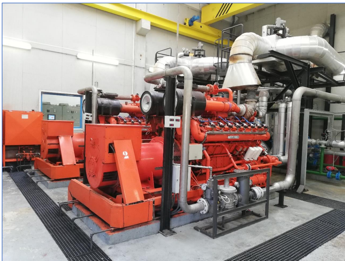
Figura 10. Instalación de cogeneración en una EDAR.
