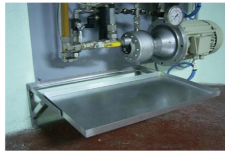
Bandejas para recogida de pequeñas fugas
