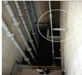
Separador de aceites en pozo de achique
