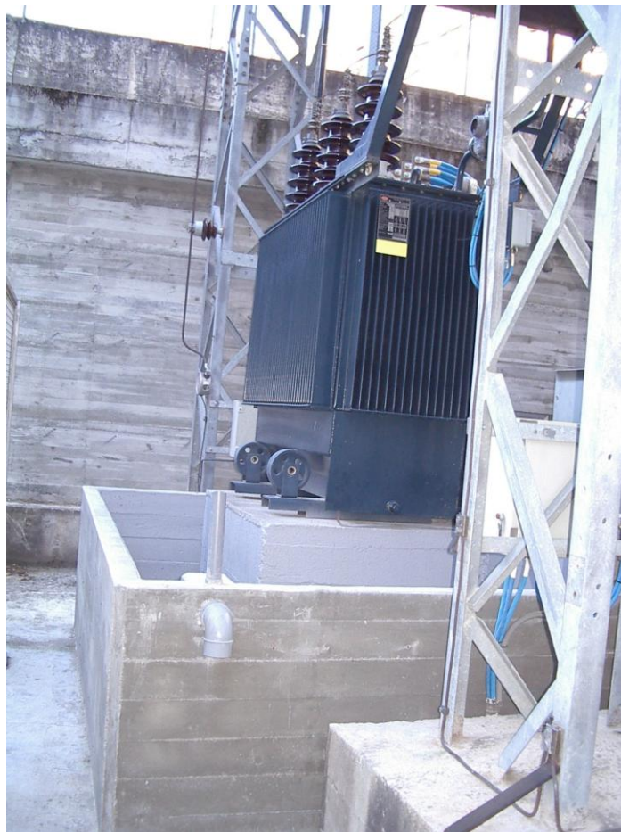
Ilustración 14: Foso de recogida de aceite de transformador. Central Hidroeléctrica de Ricobayo.
