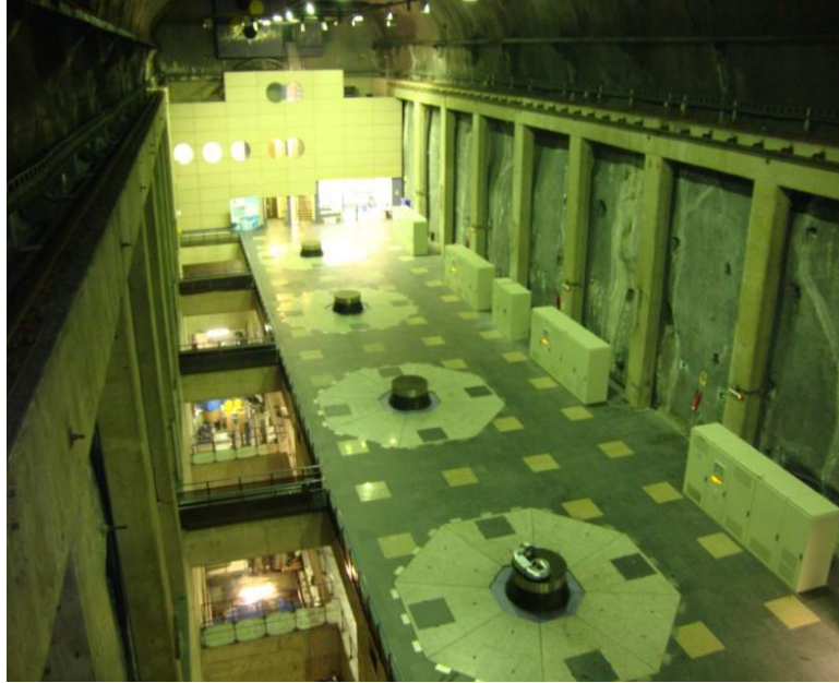
Ilustración 10: Central de Bombeo de la Central Hidroeléctrica Reversible de Sallente (Endesa). Río Flamisell (Lleida).
