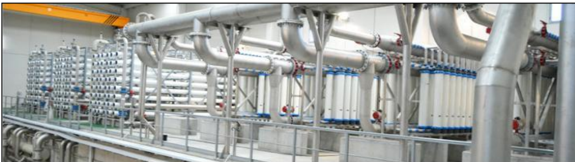
Ilustración 3: Bastidores de ultrafiltración y ósmosis inversa en la EDAR de la Cuenca Media-Alta del Arroyo Culebro (Madrid).
