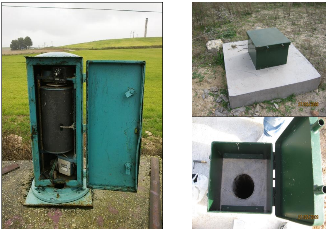
Ilustración 3: Izquierda: Piezómetro instalado y automatizado para registro continuo de niveles. Derecha: Piezómetro y arqueta para toma manual de medidas de niveles.
