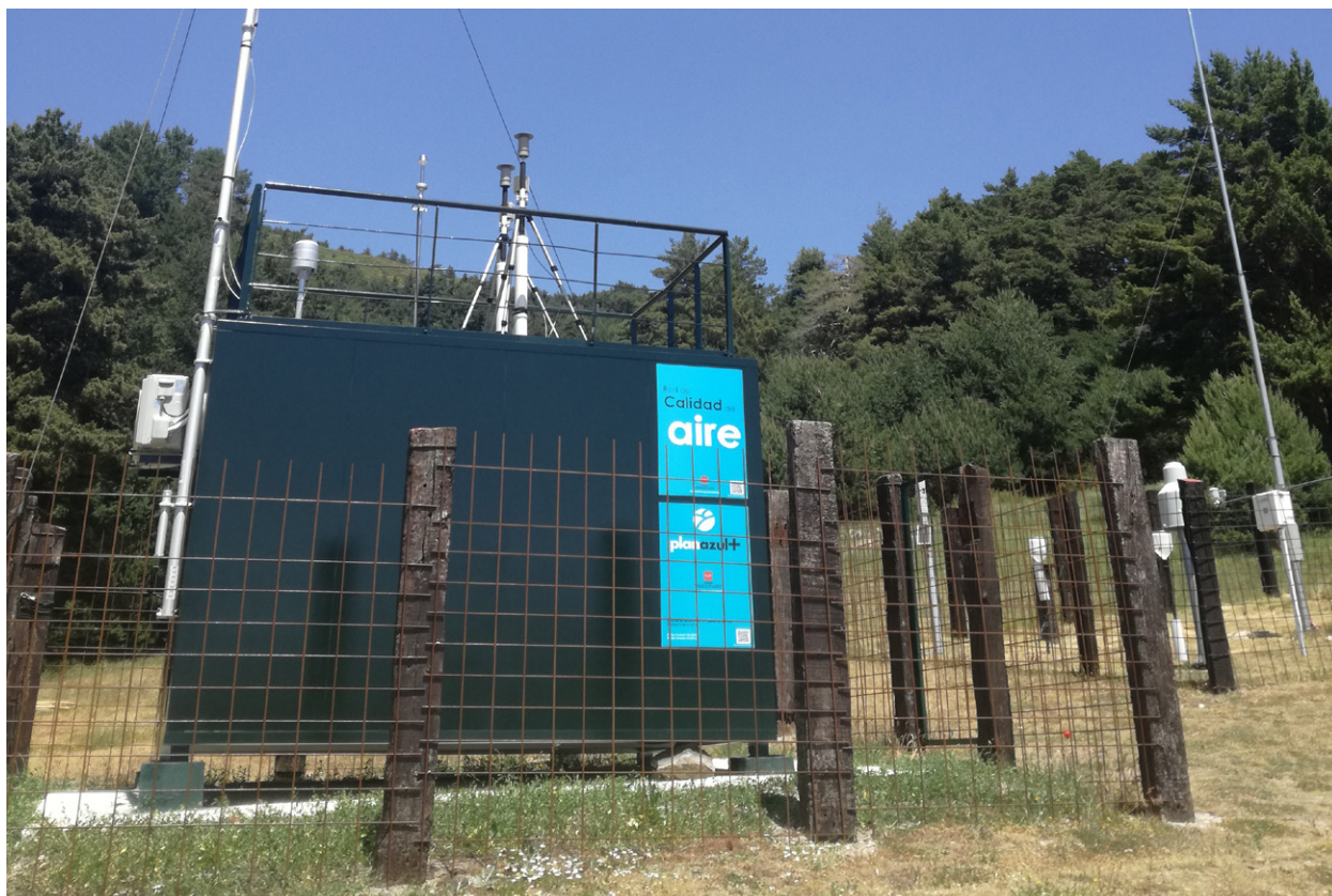
Estación de medida de la Red de Vigilancia de la Calidad del Aire del Ayuntamiento de Madrid. Fuente: Ayuntamiento de Madrid.
