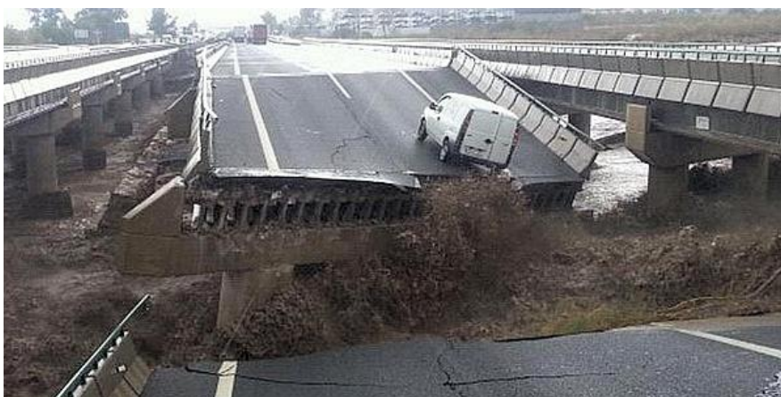
Colapso al vencer las pilas de un viaducto en la autovía A-7 entre las localidades murcianas de Lorca y Puerto Lumbreras, como consecuencia de las fuertes lluvias.
