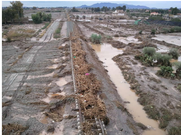
Suspensión del tráfico ferroviario entre Lorca y Águilas (Murcia) tras el paso de un temporal, provocando el colapso de las obras de desagüe, descalce de la vía y arrastre de taludes de terraplén.
