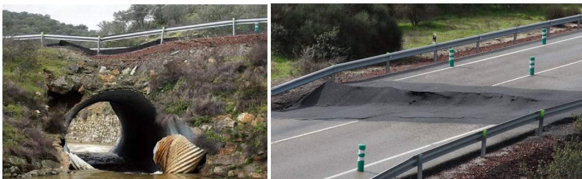
Hundimiento y derrumbe de parte de la calzada como consecuencia de la caída de un paso inferior en la carretera N-420 a la altura de Fuenaliente (Ciudad Real), debido a las fuertes lluvias.
