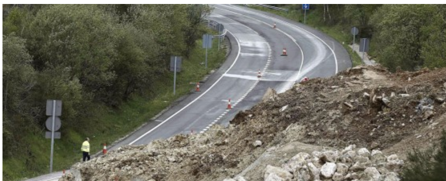
Desprendimiento de tierra en la carretera N-121-A (Pamplona/Iruña-Behobia) en las proximidades del túnel de Belate, con corte de la calzada al tráfico de vehículos durante varias semanas.
