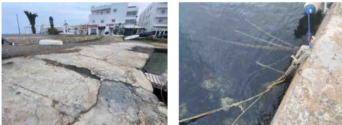
Ilustración 6 Detalle de la plataforma adosada a la Avenida de Es Canar y el refugio marítimo.
