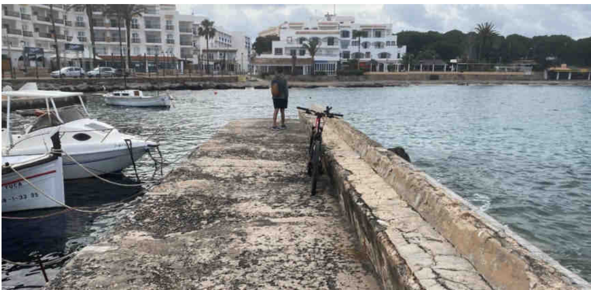
Foto 9. Vista del dique de protección y del murete bota olas en deficiente estado de conservación.
