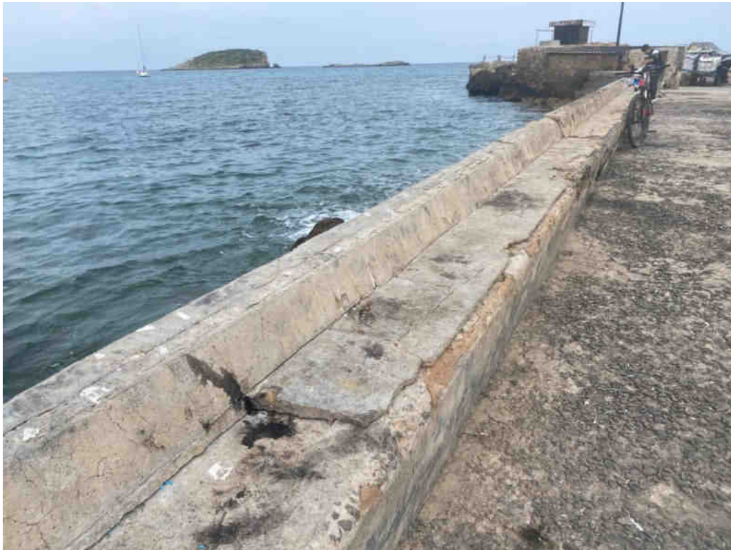
Ilustración 22 Zona para sentarse en el dique de protección, se observa el deterioro generalizado del hormigón debidos a las condiciones ambientales, aunque se observa que la estructura general sigue funcionando adecuadamente
