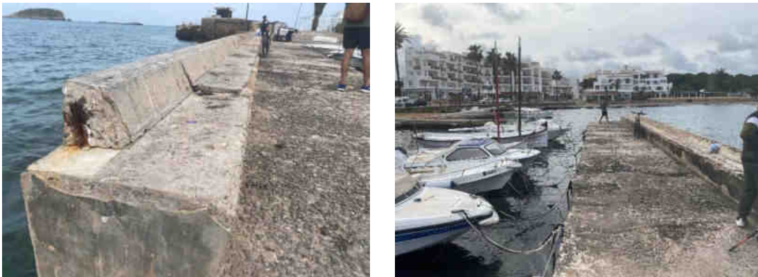
Ilustración 5 Fotografías del estado de los paramentos de hormigón y solera.
