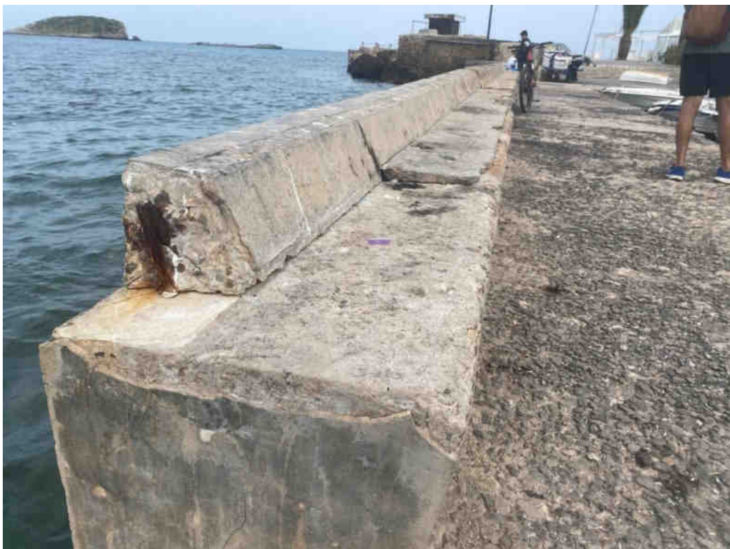
Ilustración 23 Deterioro del hormigón en la zona para sentarse del dique de protección.
