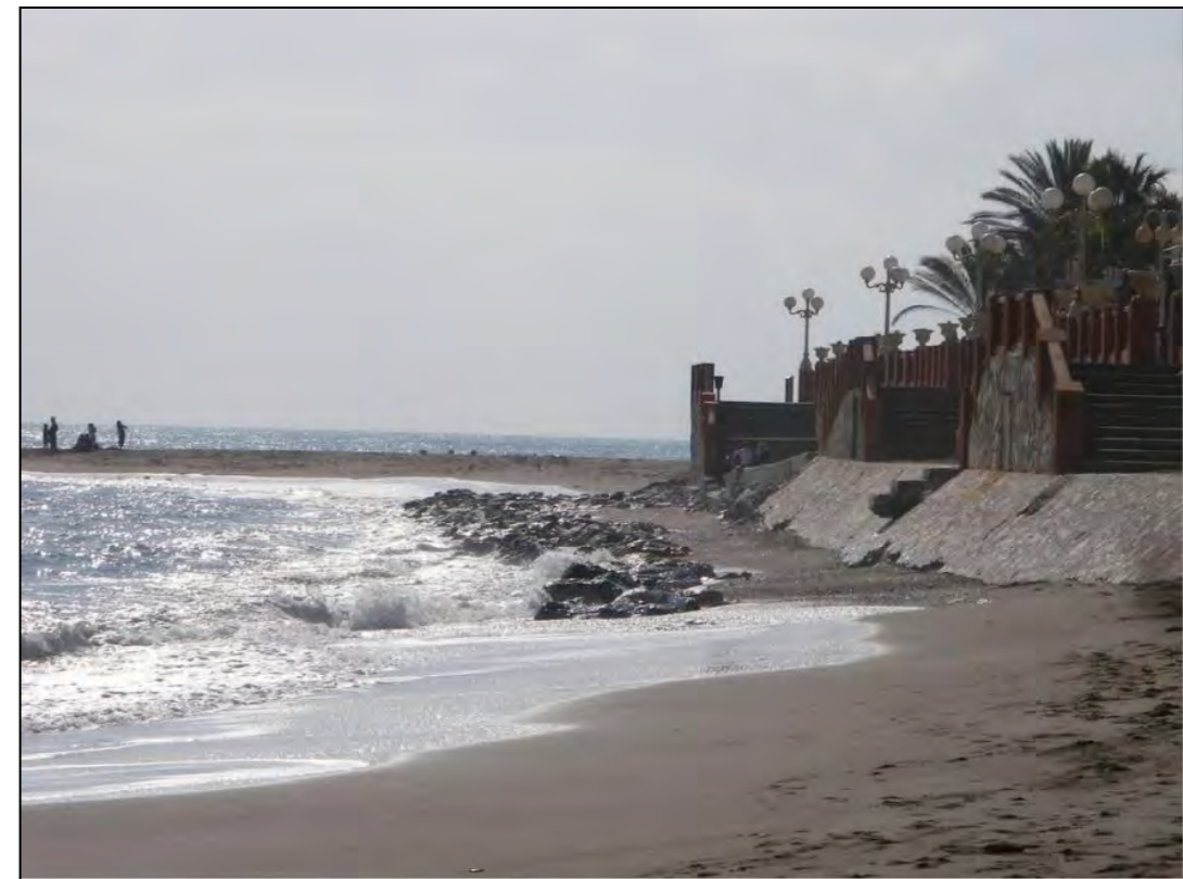
Tramo en erosión sin playa seca. Escollera colocada de protección del muro de ribera.
