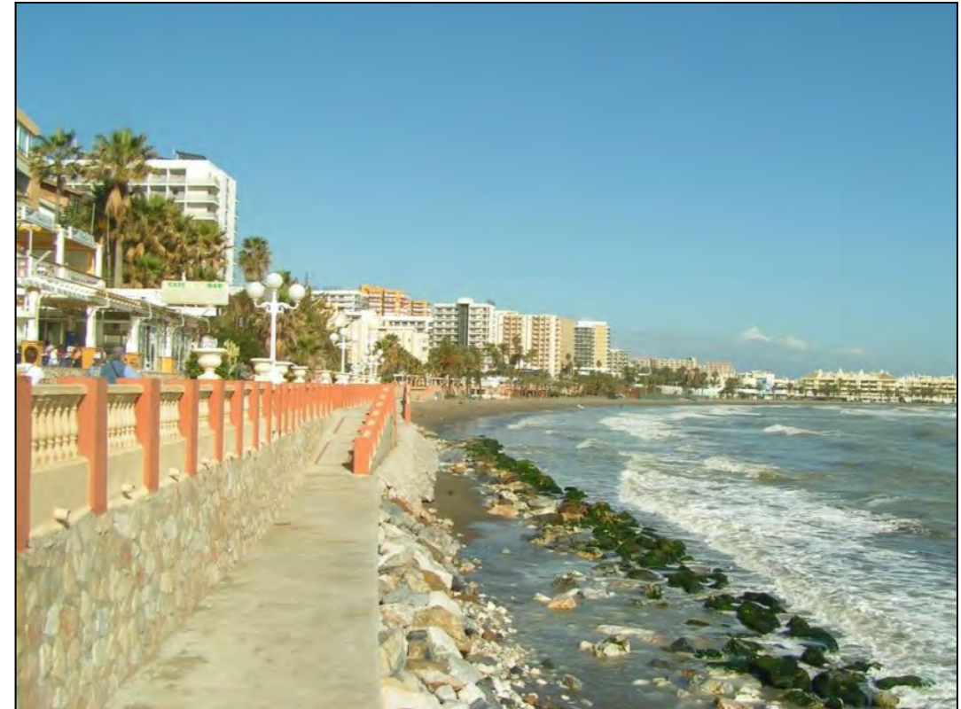
Tramo en erosión sin playa seca. Escollera colocada de protección del muro de ribera.
