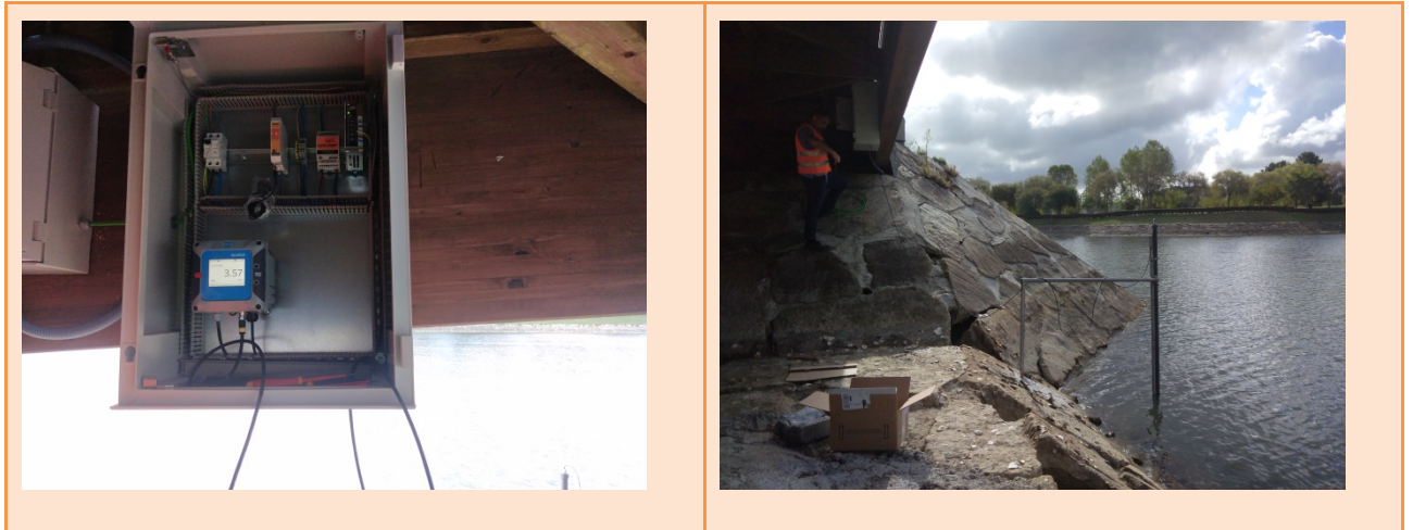
Figura 9 Instalación de turbidímetro en continuo en laguna de Fonteculler. 27.09.2022.
