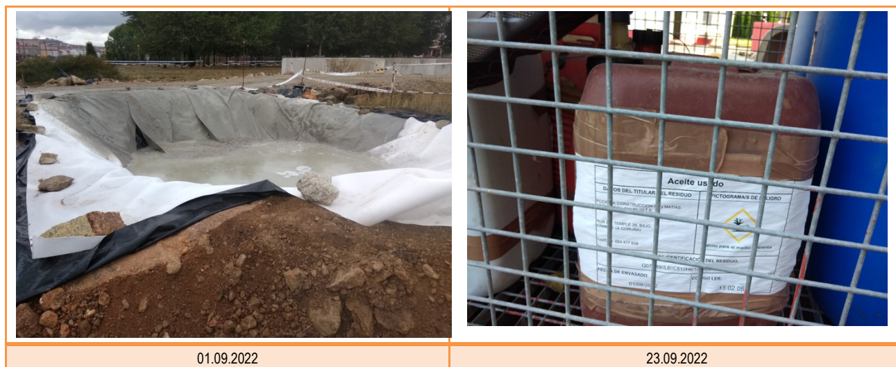
Figura 11 Seguimiento de zona de lavado de hormigoneras y instalación de residuos peligrosos.
