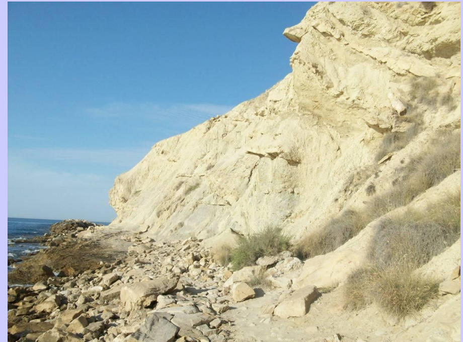
Vista general del talud saneado, con las piedras desprendidas al pie
