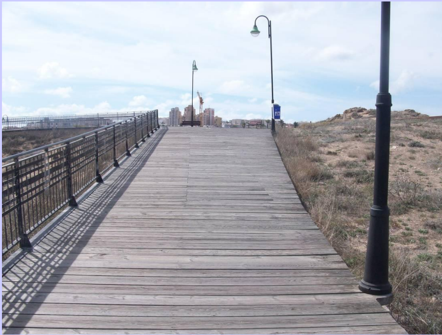
Vista de uno de los tramos deteriorados antes de la operación
