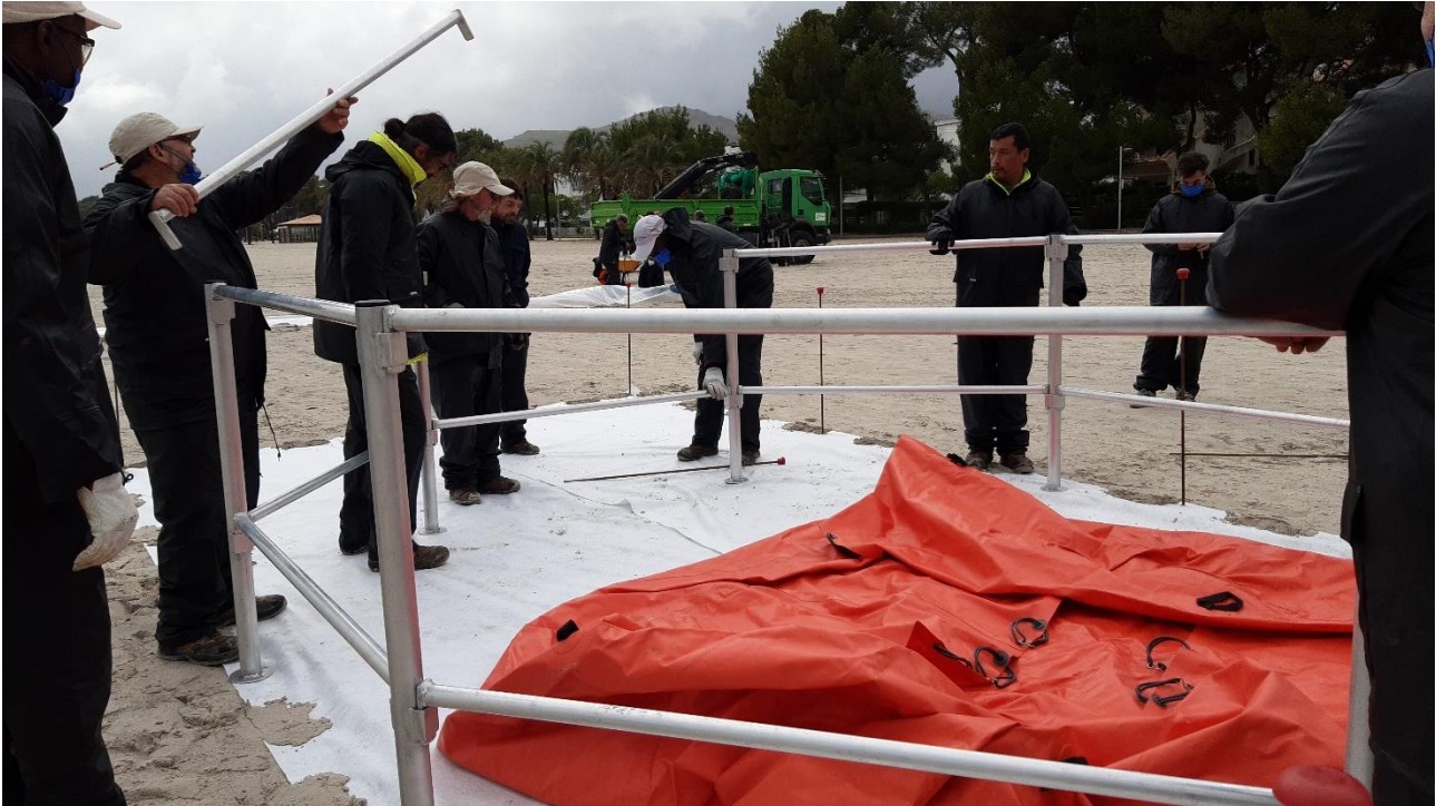
Ilustración 30. Montaje del Fast Tank en la zona de almacenamiento temporal de residuos.
