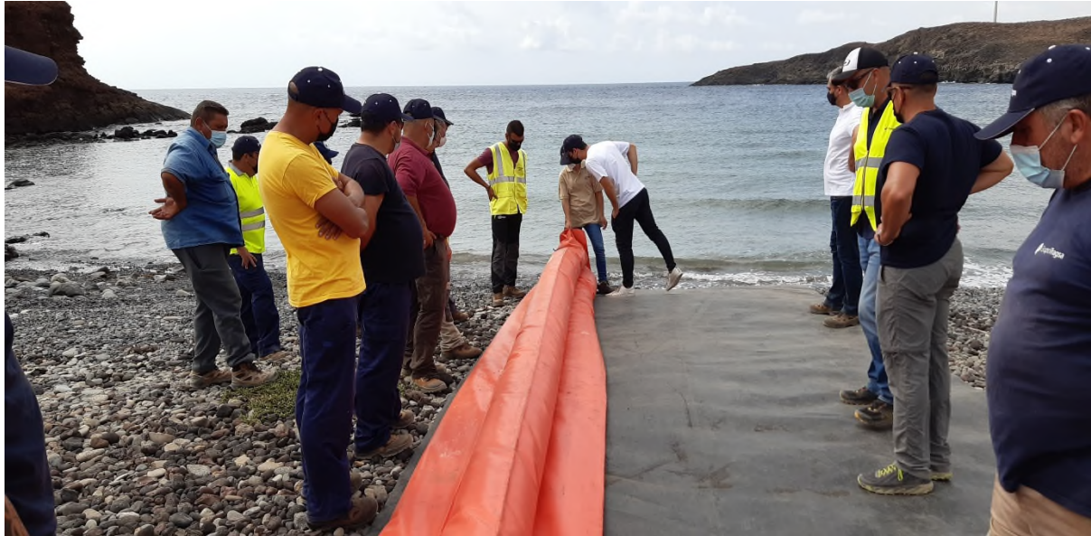
Ilustración 21. Barrera selladora una vez llena la cámara superior de aire.
