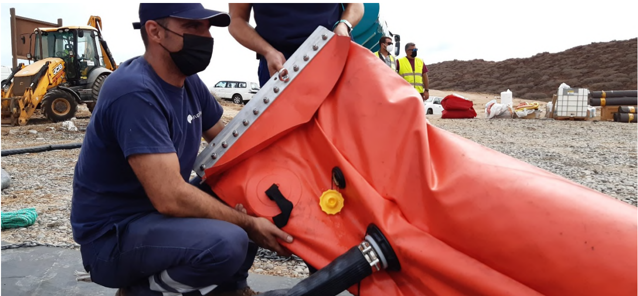
Ilustración 22. Llenado de agua de las cámaras inferiores de la barrera selladora.
