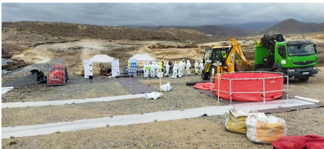
Ilustración 30. Personal interviniente al fondo equipándose con los EPI en la zona habilitada para servicios.
