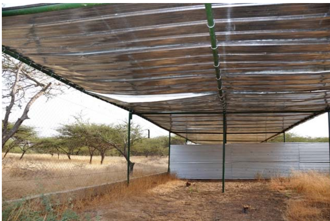
Fig. 6.- Techumbre de uno de los cercados vencidos por acción del viento (2011).
