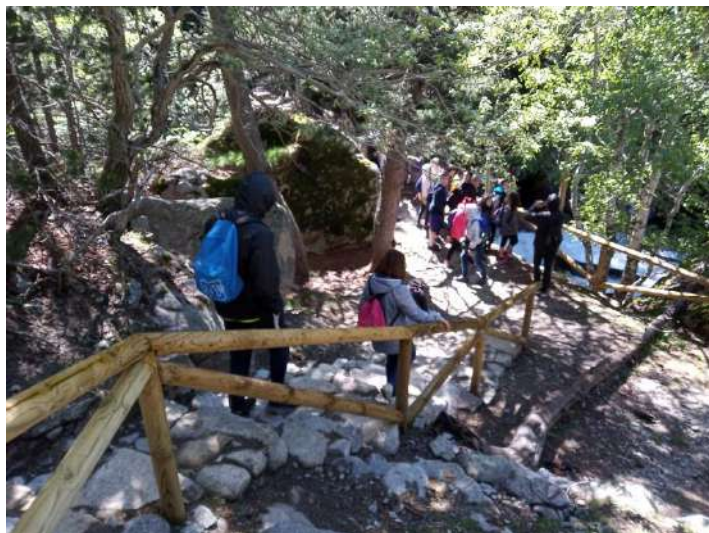
Imatges 48. Millora dels esgraons i instal·lació de nova barana al Pont de Ferro que dona accés a la passarel·la d'Aigüestortes
