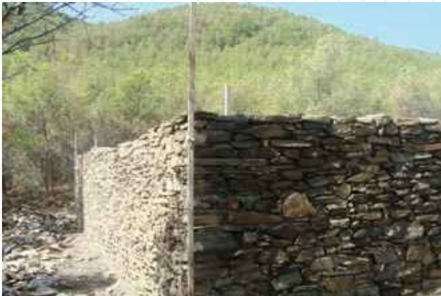
Ejecución de las obras de adecuación de la instalación de "El Entredicho".
