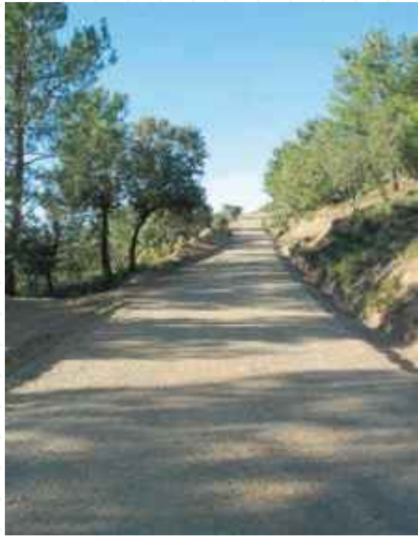
Estado del camino en el monte "Los Jarales" del T.M. de Cañar tras la ejecución de las obras.
