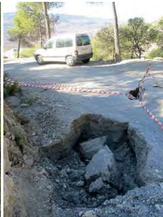
Daños ocasionados por la grieta en la pista forestal que une Marchena con la Sierra de Dúrcal
