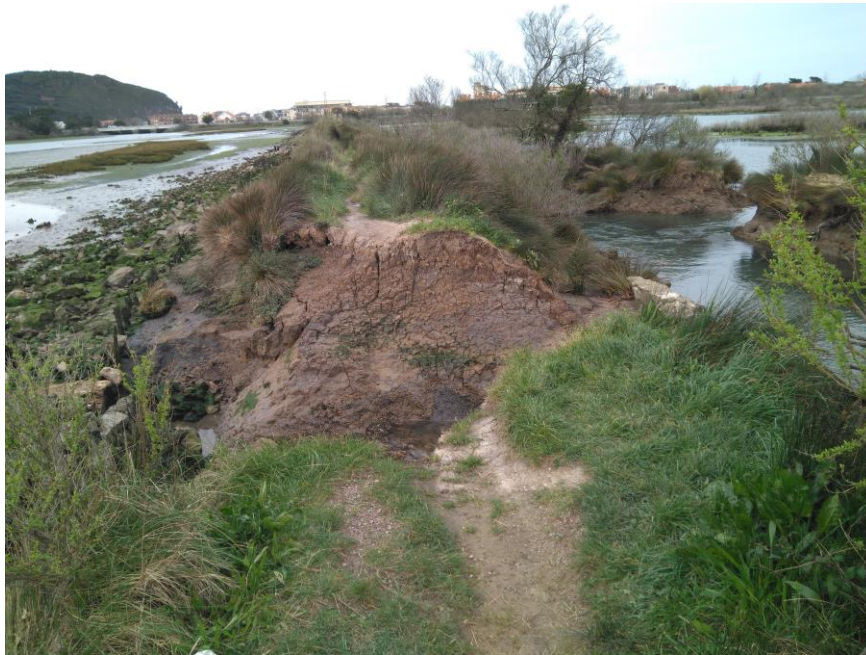
Foto 5. Rotura total del dique de contención y arrastre del material de relleno por efecto de la dinámica mareal en el punto final de las actuaciones previstas situado en el extremo norte. Imposibilidad de paso a través de él.
