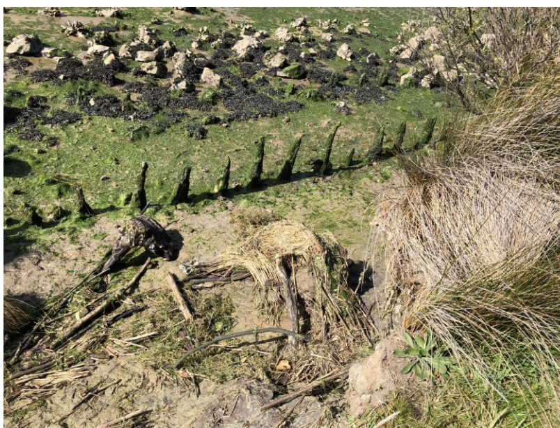
Foto 2. Detalle del arrastre de material de relleno por efecto de la dinámica mareal en el punto de inicio de las actuaciones previstas, y detalle de las tablestacas obsoletas.
