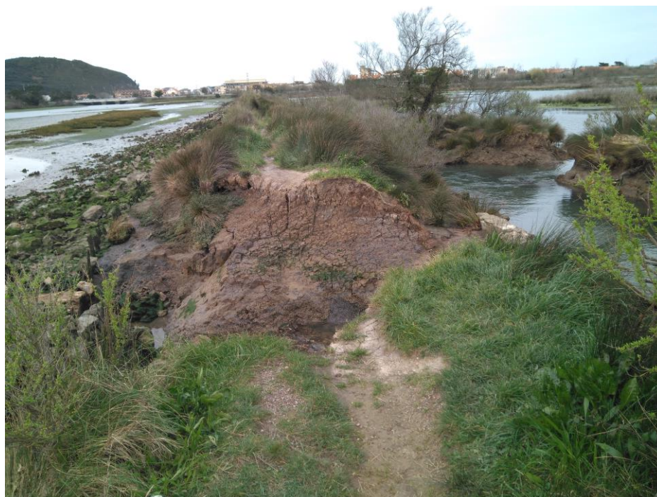
FOTOGRAFÍA 5 Rotura completa del dique en el PK 1+059.
