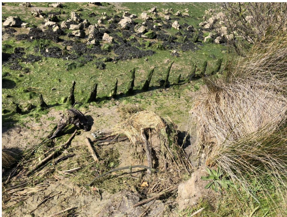
FOTOGRAFÍA 4 Ruinas de las tablestacas instaladas a fin de contener y proteger el dique.
