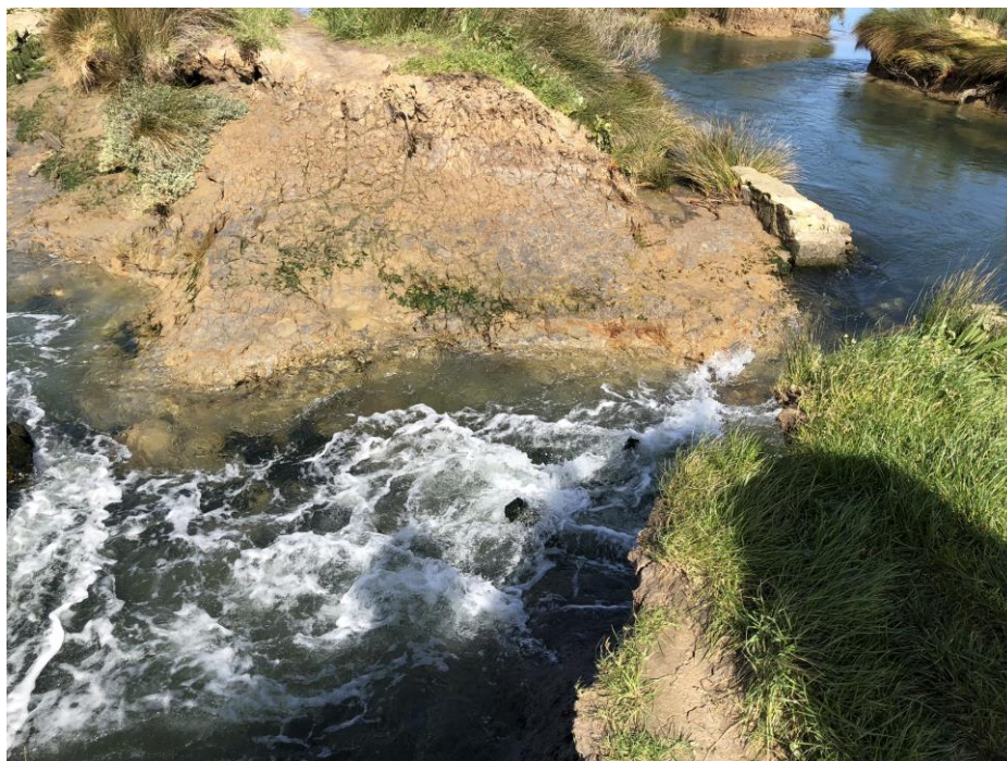
FOTOGRAFÍA 6 Detalle del paso de agua a través de la rotura completa del dique.
