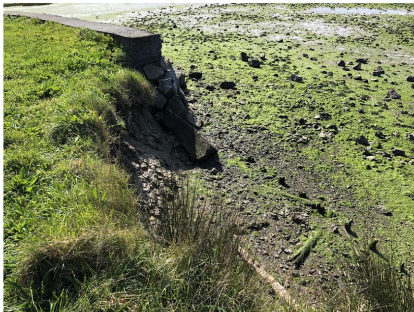
Foto 3. Punto de comienzo de las actuaciones y lugar de empalme con el muro de contención ya existente, junto al caseta de avistamiento de aves.
