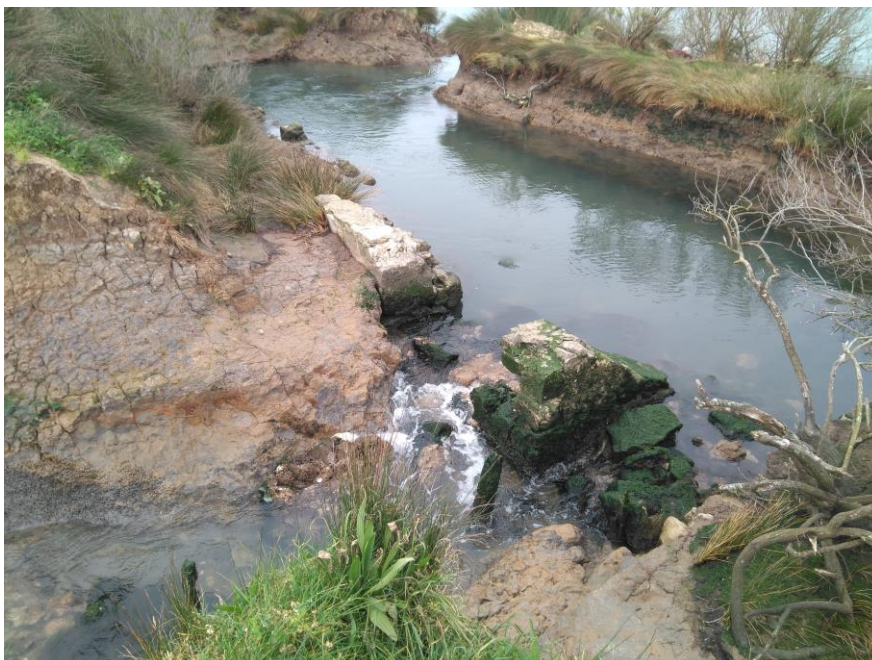
Foto 8. Detalle de los taludes en los frentes del paso de agua a través de la rotura total del dique.
