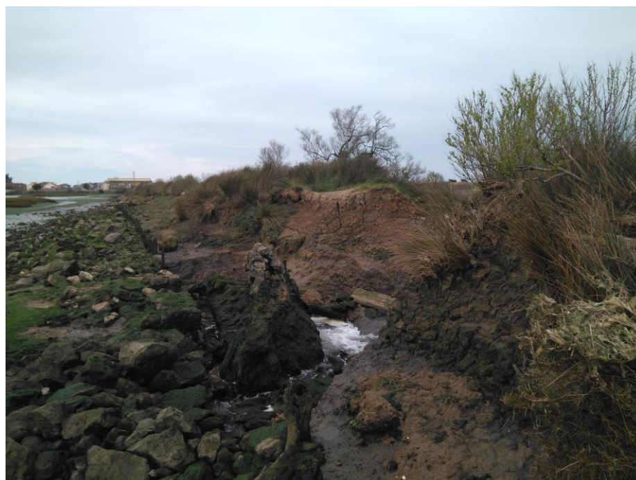
Foto 10. Perspectiva inferior de la rotura total del dique y vano a salvar mediante pasarela peatonal metálica.
