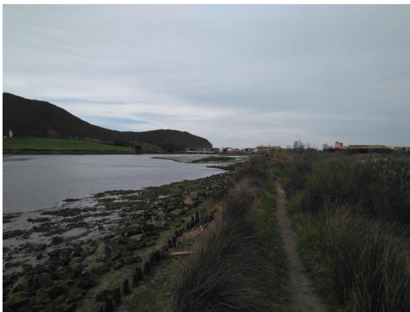
Foto 1. Erosión avanzada del dique de contención y arrastre del material de relleno por efecto de la dinámica mareal en el área de actuación.
