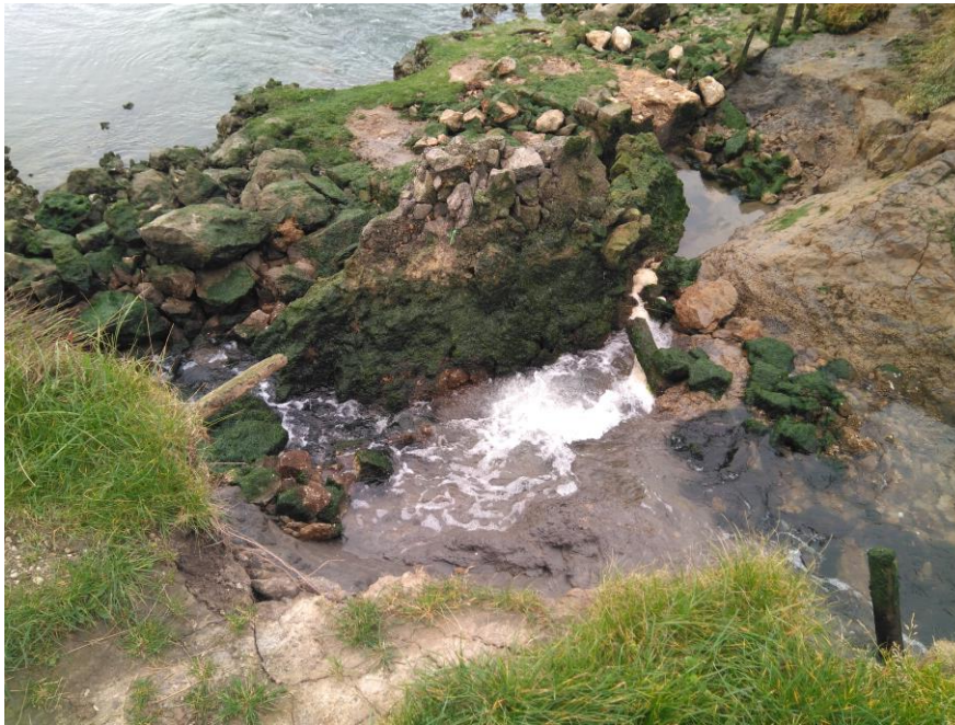
Foto 7. Detalle de los taludes en los frentes del paso de agua a través de la rotura total del dique.
