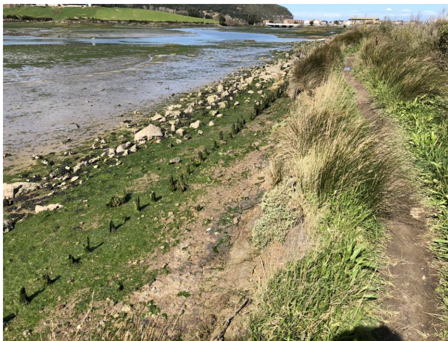
FOTOGRAFÍA 3 Punto de pérdida de material del dique por erosión de las carreras de marea.
