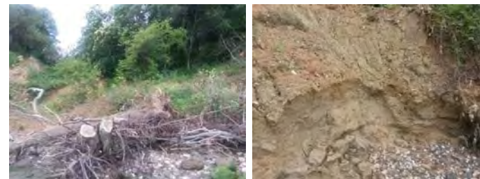
Fotos 14 y 15.- Deslizamientos Zona 4, y detalle de erosión por parte de la marea en el pie.
