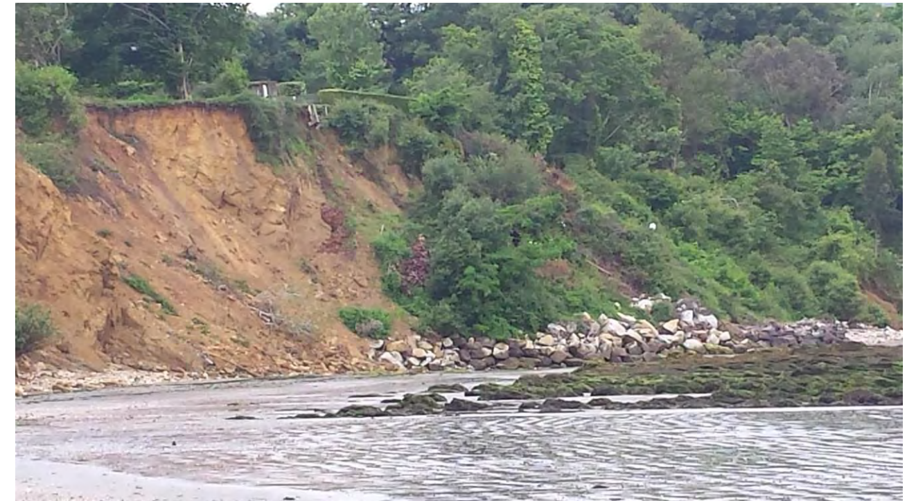
Foto 7.- Protecciones puntuales existentes
