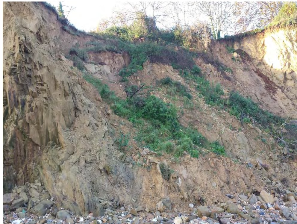
Fotografía nº 2: Desprendimientos en taludes de la zona oeste de la playa do Regueiro
