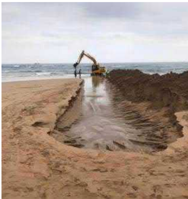
Figura 3.2-16: Ejemplo de instalación del cable en una zanja en la playa (Fuente: Cable Marea en playa de Sopela, SubCom, 2017).
