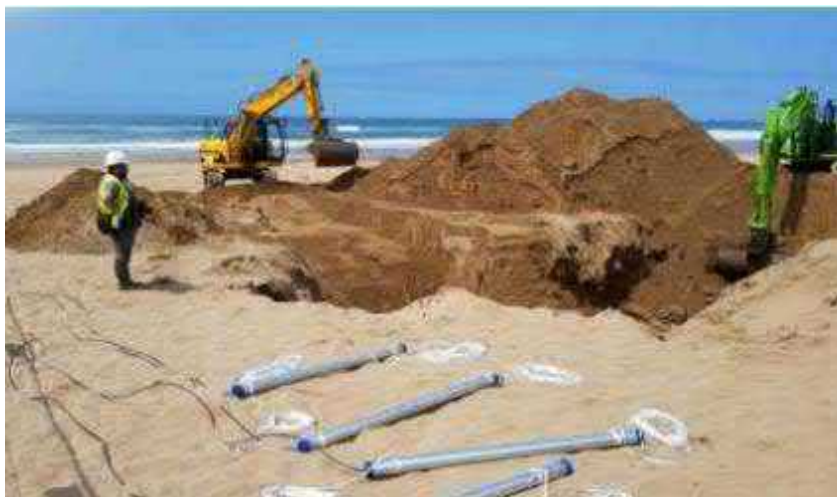
Figura 3.2-18: Zanja de al menos 3 m de profundidad para la cama de ánodos de puesta a tierra (Fuente: SubCom, 2020).
