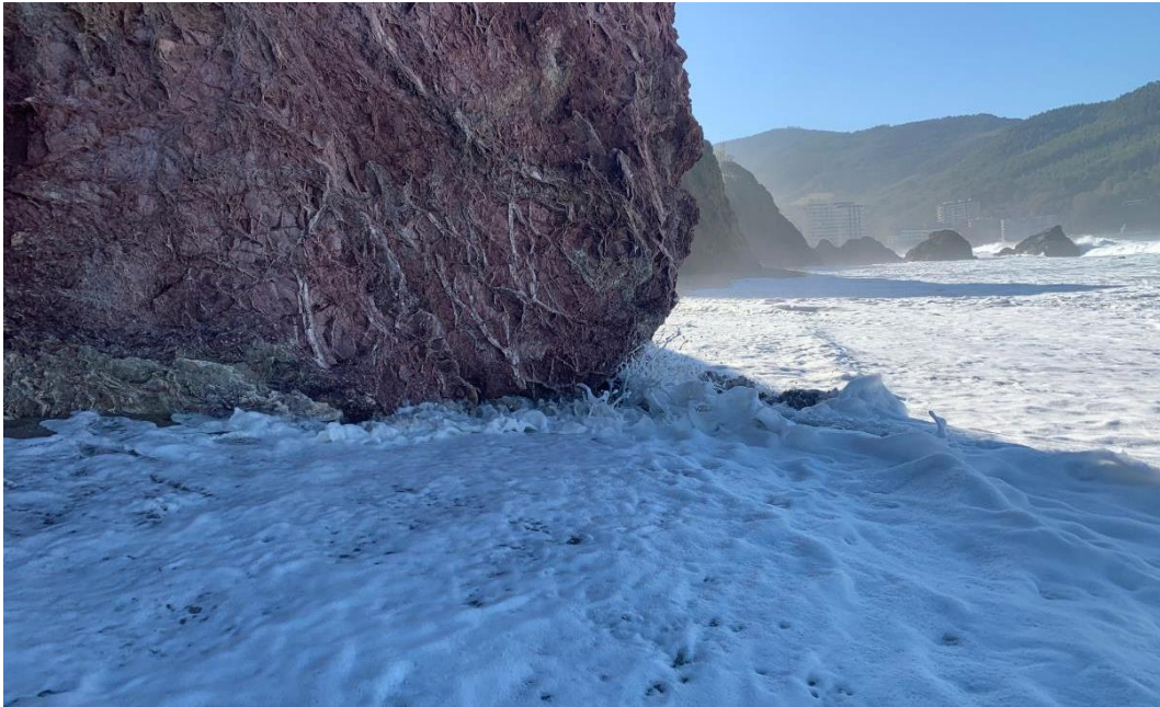
Detalle del pie del acantilado, a la altura del M-79
