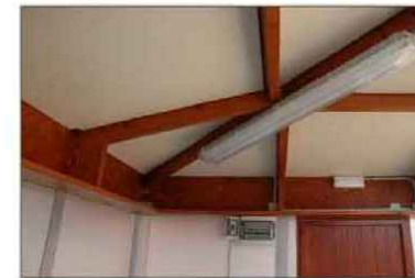
Instalación eléctrica básica de iluminación y cuadro general
