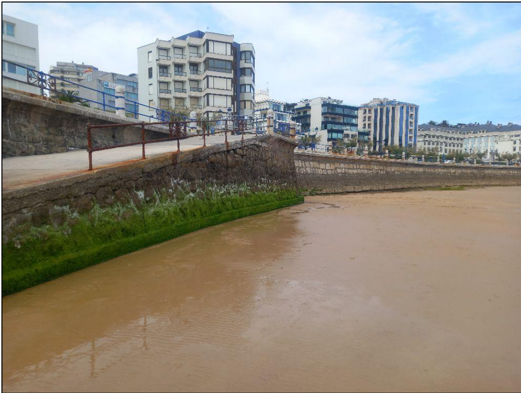
Ilustración 37. Comunidades RS/RMS/RMI/AM. Rampa de acceso al Sardinero 2 cubierta de enteromorpha sp.
