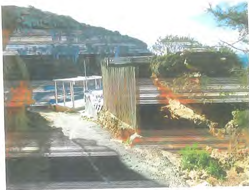
Fotografía 12. Letrinas existentes, camino hormigonado y tarima sobre caseta varadero.
