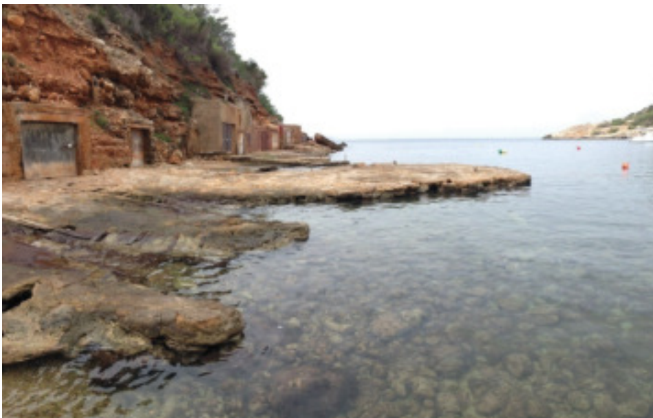
Fotografía 2. Ligeros descalces existentes bajo el embarcadero debido al movimiento de los bloques de escollera a causa del oleaje. Fuente: Propia.
