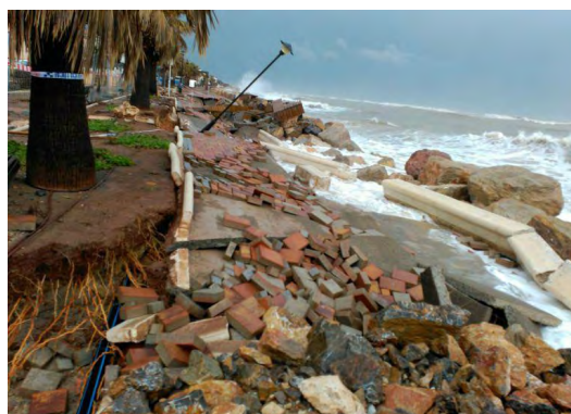
Paseo marítimo de Almenara tras el temporal de Enero de 2017
