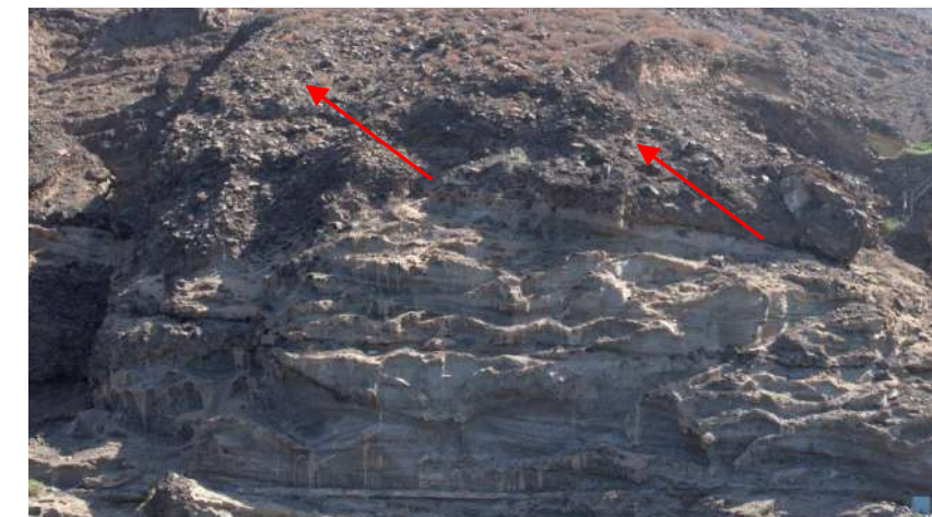
Figura 24. Tramo en precario por desprendimientos. Fuente: Elaboración propia
