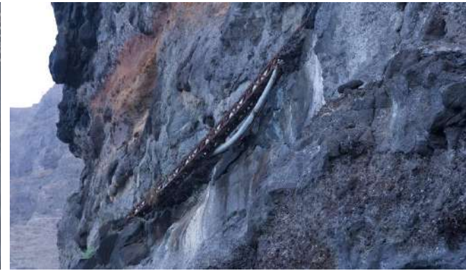
Figura 11. Mal estado de conservación. Fuente: Elaboración propia
