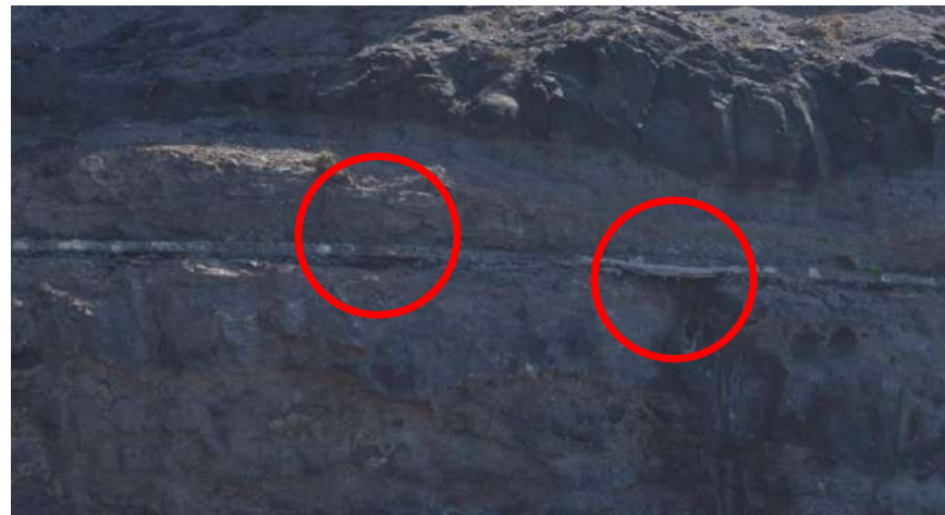
Figura 16. Tramo en precario por descalses. Fuente: Elaboración propia
