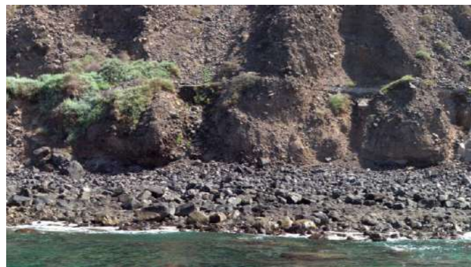
Figura 12. Tramo en precario por desprendimientos. Fuente: Elaboración propia
