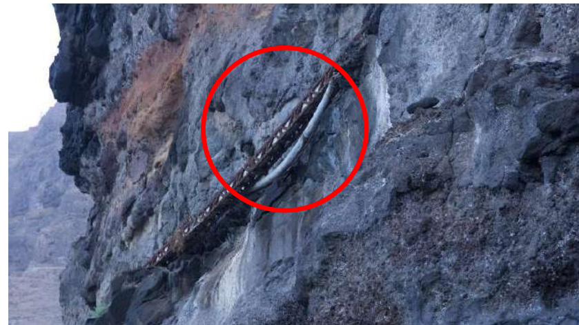
Figura 17. Mal estado de conservación. Fuente: Elaboración propia
