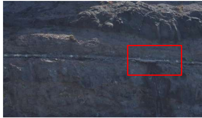
Figura 10. Tramo en precario por descalces. Fuente: Elaboración propia
