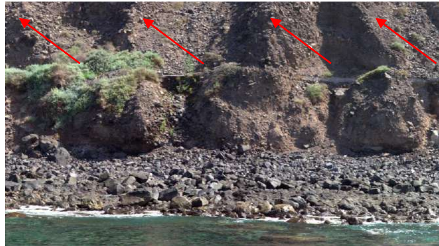
Figura 21. Tramo en precario por desprendimientos. Fuente: Elaboración propia
