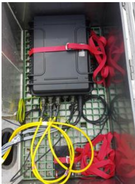
Figura 3. Caja con el data logger y salida de cableado
