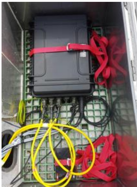
Figura 6. Caja con el data logger y salida de cableado
