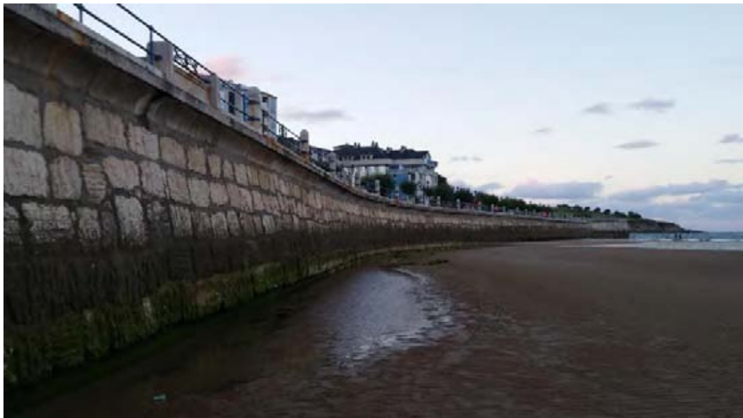
Imagen 4: Vista del muro del paseo marítimo tomada desde la zona de la playa
